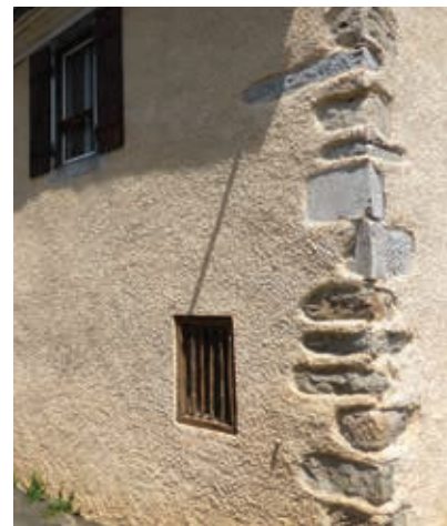
⬆ Surrèpasseur d'enduit créant des bourrelets entre les pierres de la chaîne d'angle. © C.A.U.E.64
