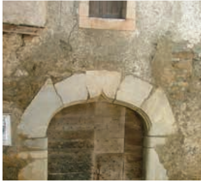
▲ Enduit avec badigeon altéré. © C.A.U.E.64
