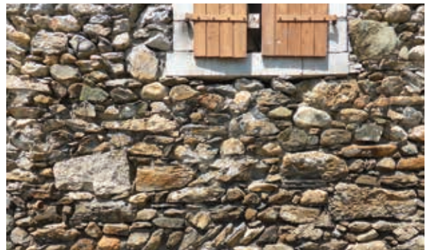
▲ La mise à nu de la maçonnerie tout-venant hétérogène, ici faite de grès, de calcaires et de galets d'épierrage, l'expose à une altération accélérée. © C.A.U.E.64
