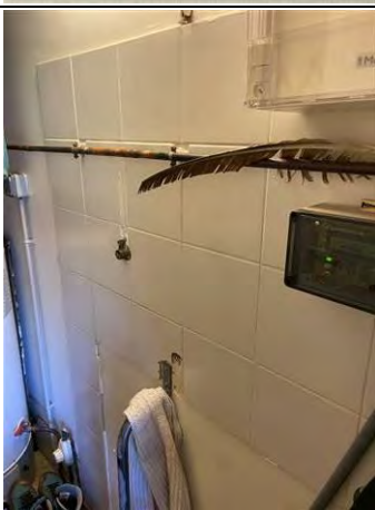
Photo n° PhA021 Localisation : 1er étage - Chaufferie Ouvrage : 3 - Parois verticales intérieures - Revêtements de murs, poteaux, cloisons, gaines, coffres Partie d'ouvrage : Colle de faïence Description : Colle de faïence Localisation sur croquis : M024
